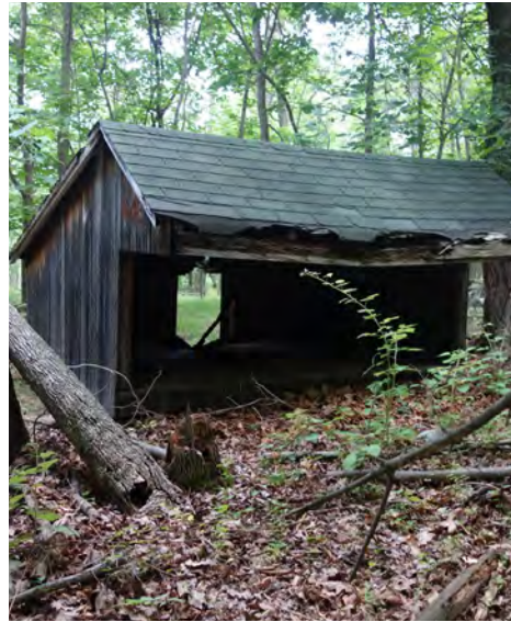
Broken camping structure (Image 3.4.4.3).
